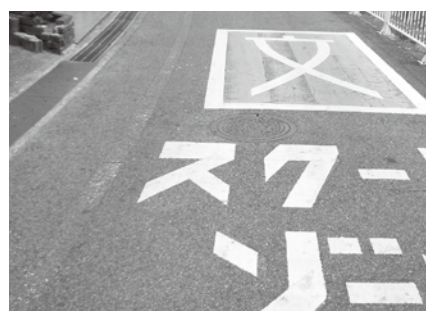
白線が消えかかっている道路
