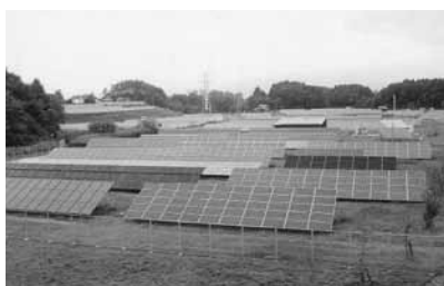
北杜サイト太陽光発電所
