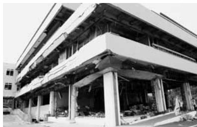
壊滅状態の女川町役場
