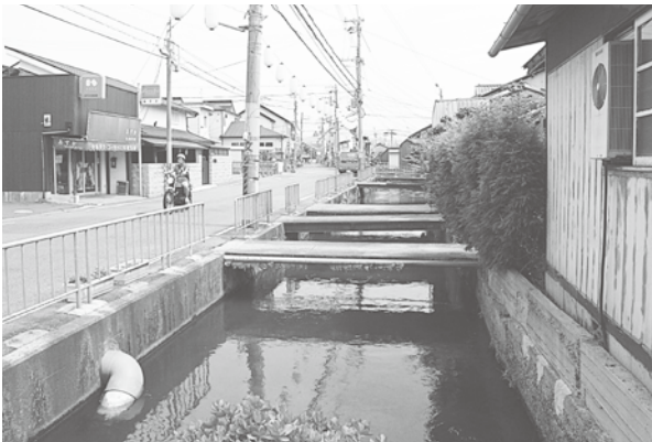
改修が待たれる平野川（古町地区）
