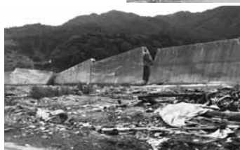
▲震災で崩壊した堤防
