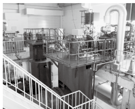
片山雨水ポンプ場内部
