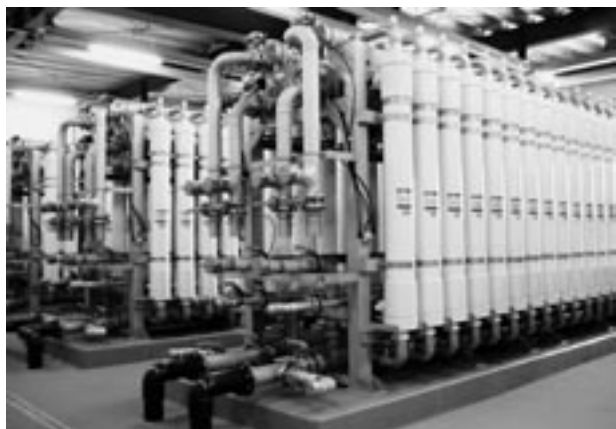
膜ろ過施設が稼動
