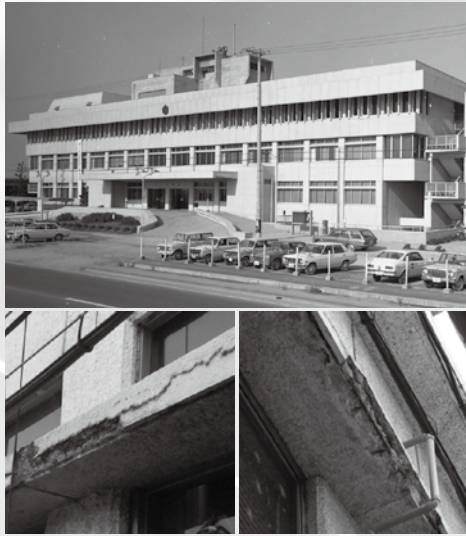
(上) 建築後間もない市役所本館のすがた（昭和44年撮影） (下) 資料：表面が剥落する庁舎外壁
