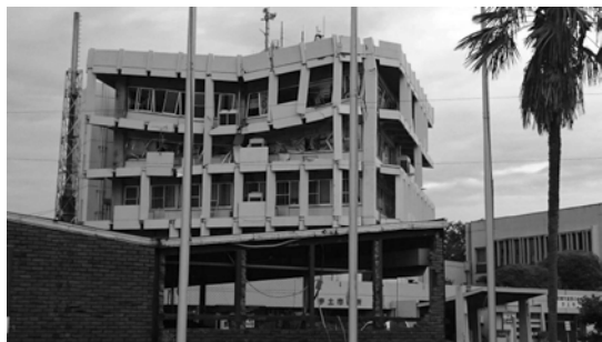
被害を受けた宇土市役所庁舎
