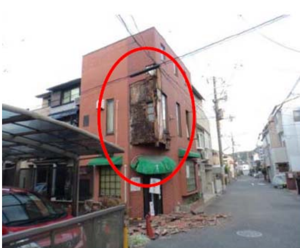
外壁が破損している
