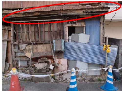
軒に不陸、剥離が生じている
