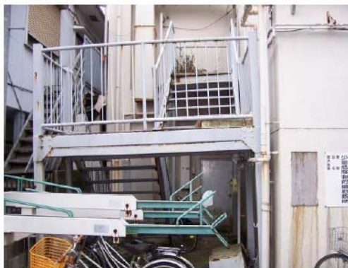
屋外階段が傾斜している
