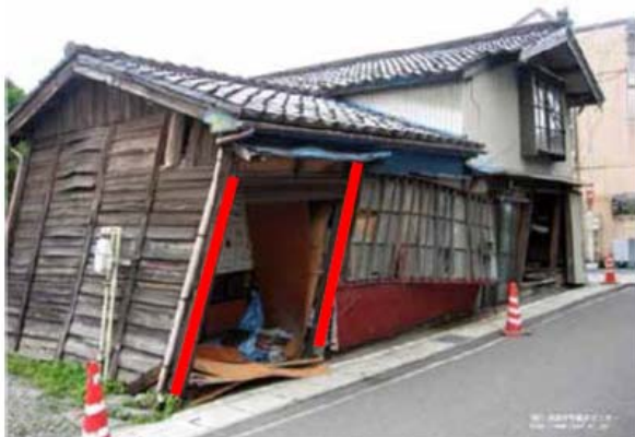
外壁が大きく傾斜しており、建具や窓枠がはずれ、原型をとどめていない
