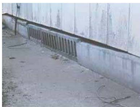
基礎が沈下し破損している
