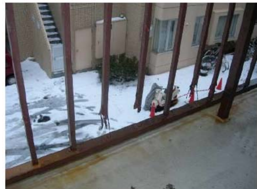
バルコニーの手摺りが腐食している
