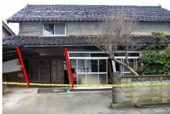
1階部分が傾斜している
