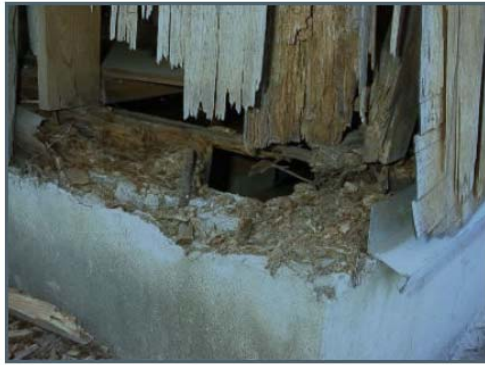
蟻害が発生し欠損している
