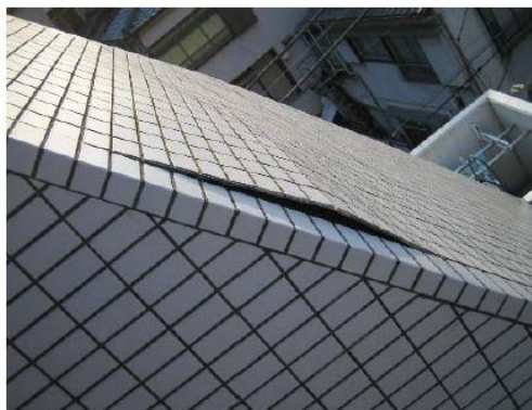
外壁に浮きが生じている
