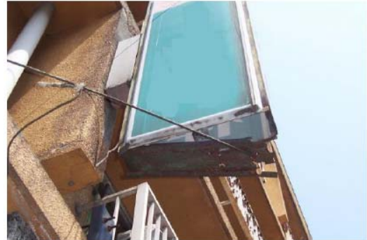
底板に腐食生じている
