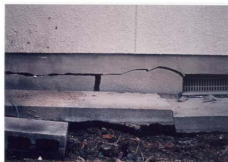
基礎が大きく破損している
