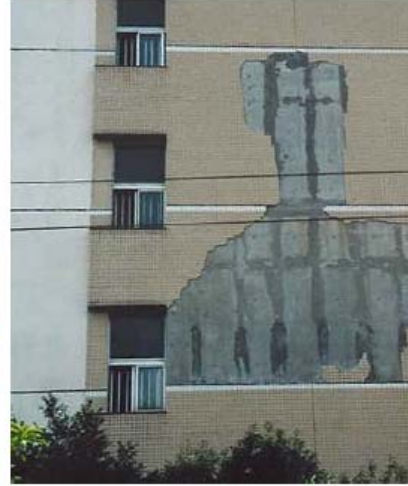
外壁に脱落が生じている
