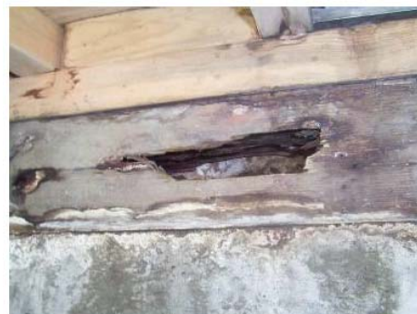
土台に蟻害が発生している
