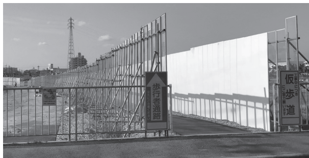
安全確保のために待ち望まれる歩道整備
