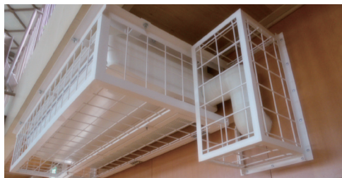
学校体育館の空調設備
