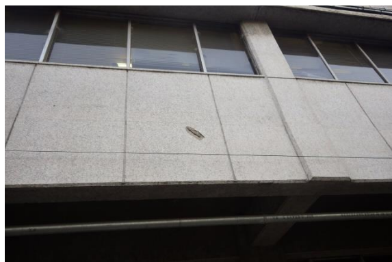
図 1-2 本庁舎老朽化の状態①
