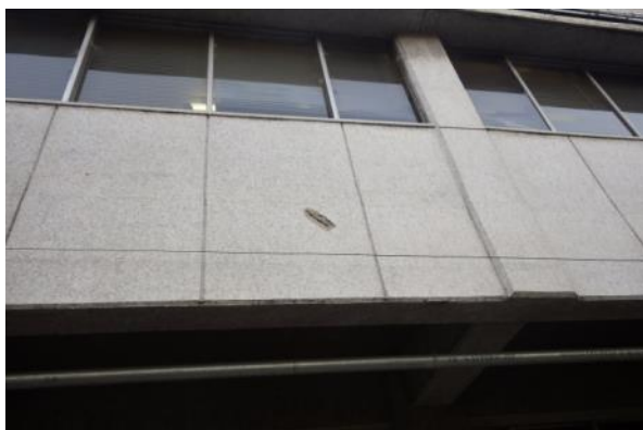
図 1-2 本庁舎老朽化の状態①
